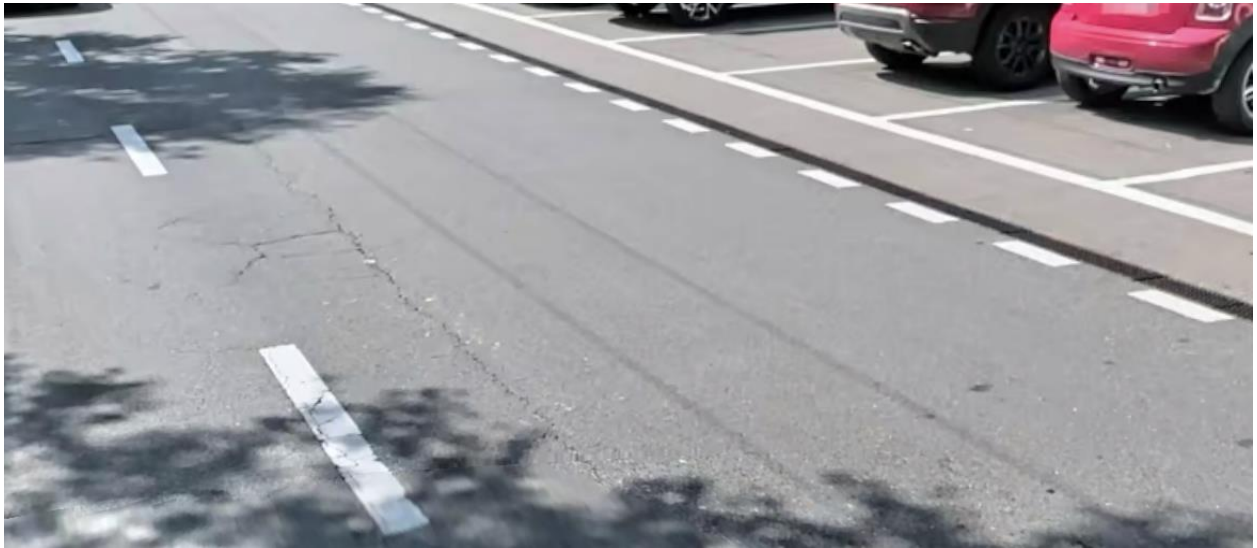
Figure 17 - Fissures sur le revêtement bitumineux
