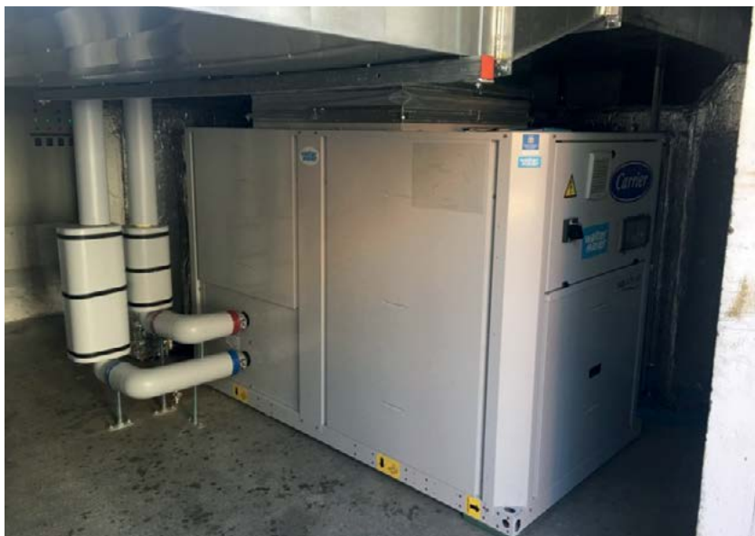
La pompe à chaleur de l'école de Châtelaine
