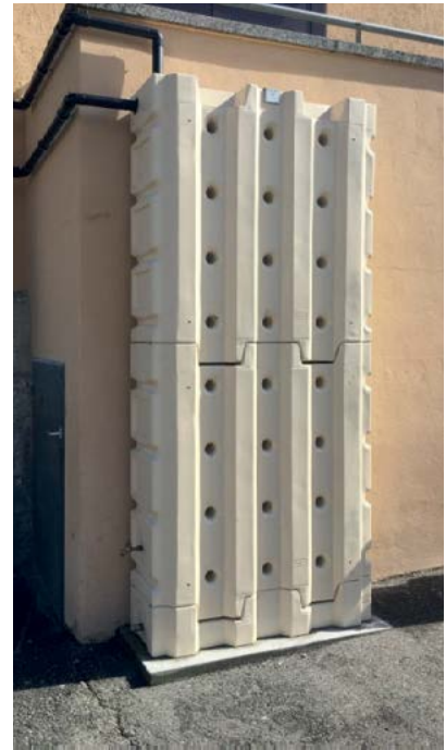
Récupérateur d'eau pluviale à l'école de Châtelaine
